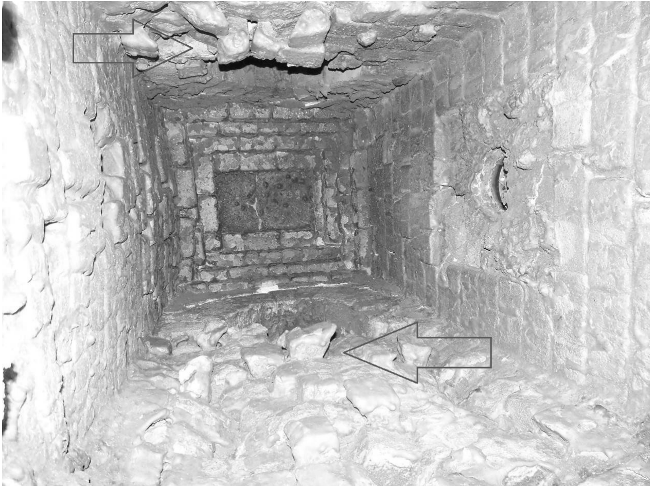
Bild 1 - Nachbrennkammer Ofen 1 mit starken Auswaschungen an der Prallwand gegenüber dem Brenner und mit aus dem Verband tretenden Steinen an den Seiten
