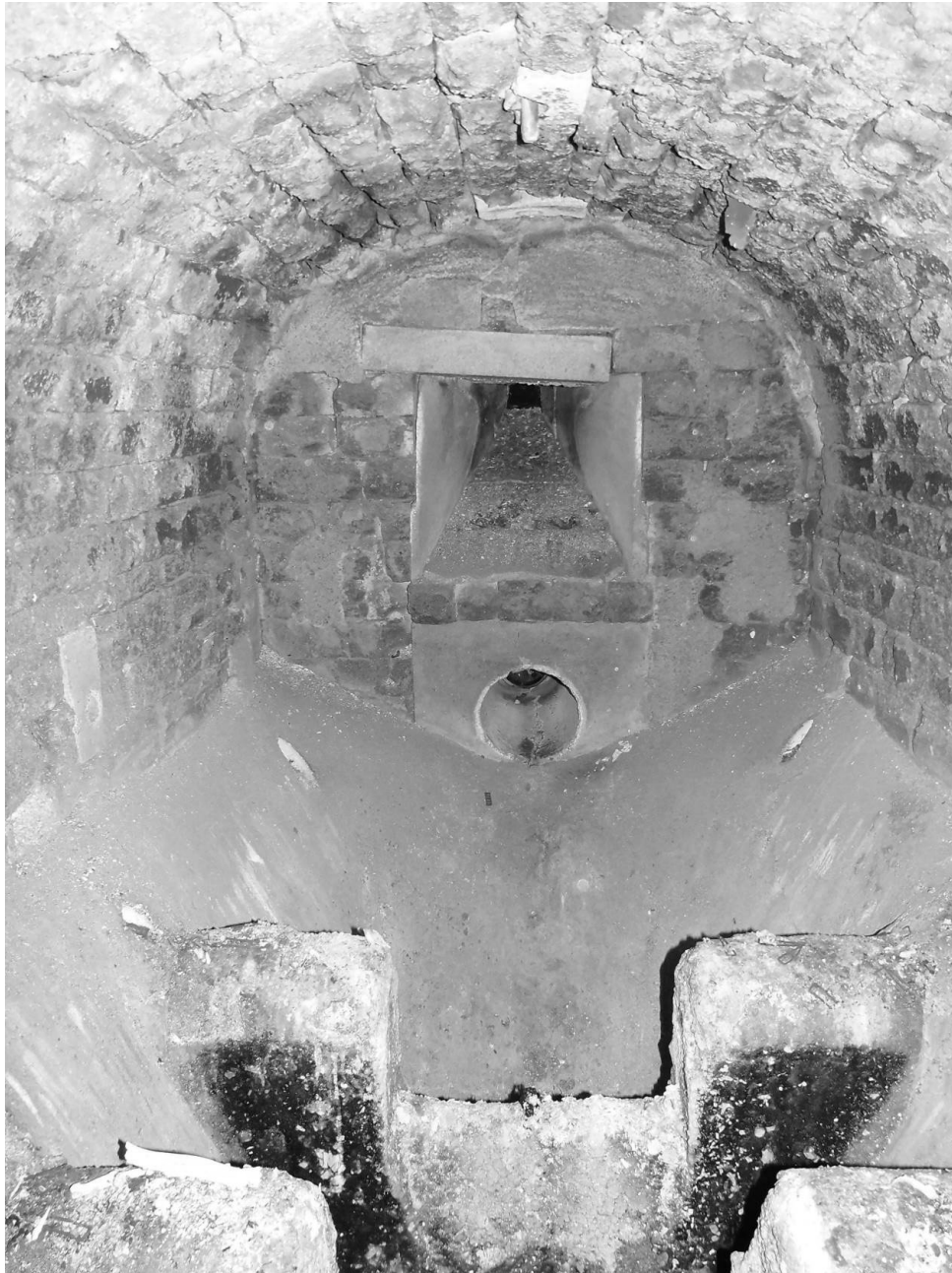
Bild 2 - Hauptbrennkammer Ofen 1 mit stark ausgewaschenen/abgeplatzten Steinen im Gewölbe
