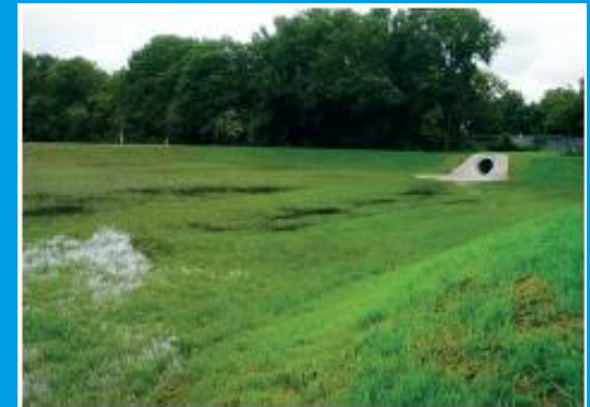
Regenrückhaltebecken Lissaboner Straße
