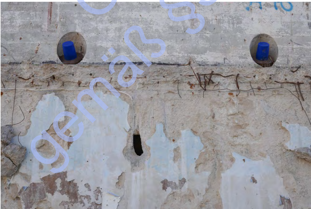
Abb. 6: Löcher und Halbhöhlungen an den Wänden der Baugrube
