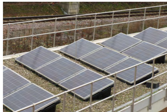
Photovoltaikanlage am Standort Unteres Rheinufer (Foto: Stadt Ludwigshafen, Bereich Stadtentwässerung)
