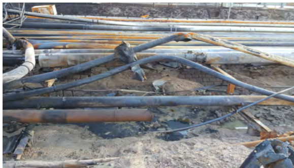
Beschädigter Rohrleitungsgraben BASF Nordhafen (Foto: Stadt Ludwigshafen, Bereich Umwelt)
