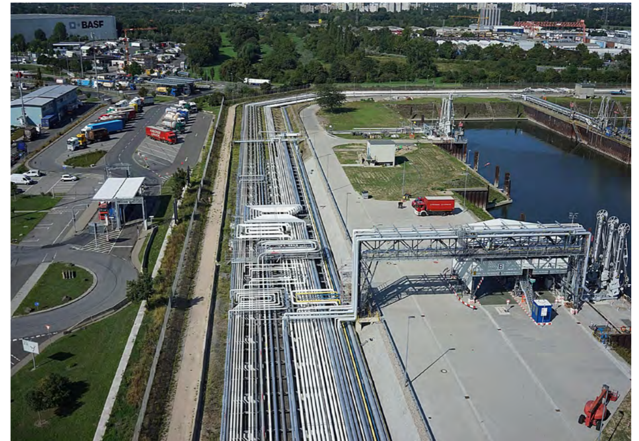
Die Unglückstelle im Nordhafen nach erfolgreicher Sanierung und Wiederherstellung der Anlagen im Jahr 2019 (Foto: BASF SE).
