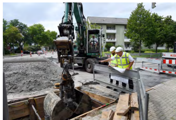
Fernwärmerohre werden meist unterirdisch verlegt (Foto: TWL, Fotograf: Thomas Henne)
