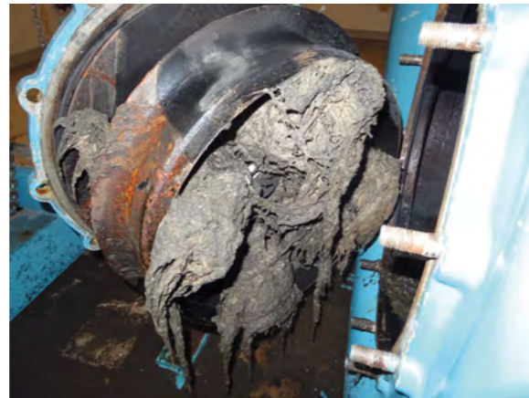
Pumpe mit Verzapfungen an den Laufrädern (Foto: Stadt Ludwigshafen, Bereich Stadtentwässerung)
