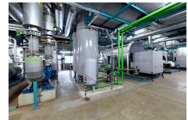
TWL-Heizwerk Pfingstweide (Foto: TWL, Fotograf: Thomas Henne)
