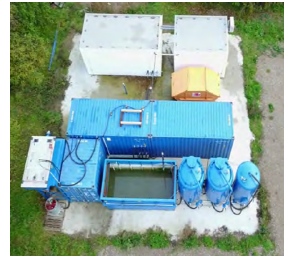
Wasseraufbereitungsanlage (Foto: BCE Koblenz)
